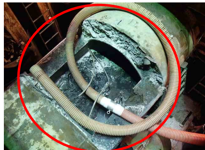
破損した、配管部分
