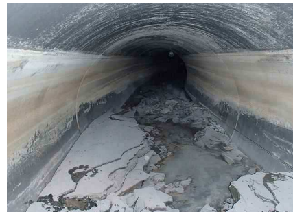
散乱した土砂、汚泥が配管内に蓄積
